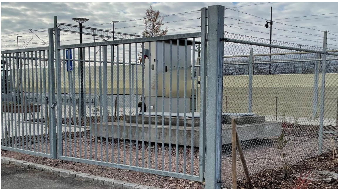
Figur 12. Pumpstation för spillvatten.
